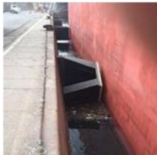
Figura 1 - Defesa danificada. Item a ser constatado e relatado.
