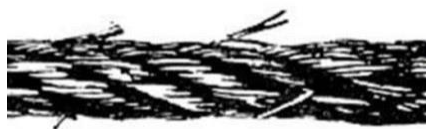
Figura 4 - Cabo de aço com vários arames rompidos.
